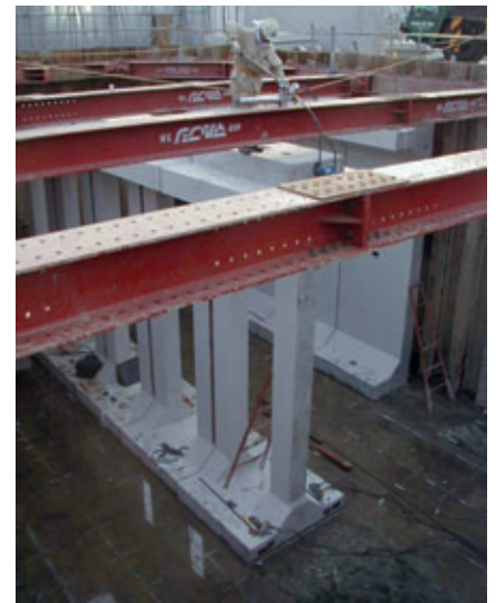
La figure 4 montre la méthode d'assemblage sur chantier. Les éléments en forme de I sont reliés par technique de précontrainte afin de garantir la résistance aux séismes.
